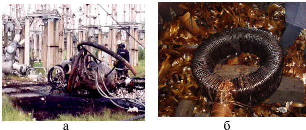
Рис. 3 – Виведені з експлуатації трансформатори струму 750 кВ
