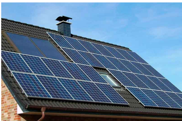
Рис. 1 – Установленные солнечные батареи на крыше частного дома
