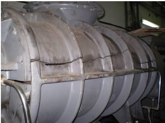
Рис.1 Разрушение корпуса насоса
